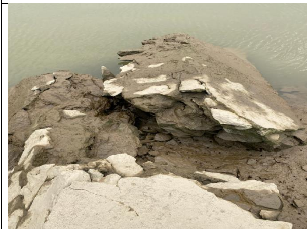
Hình 4. Mái phía sông lún sập
