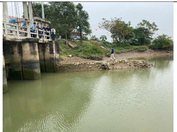
Hình 5. Mái phía sông sỏi lở
